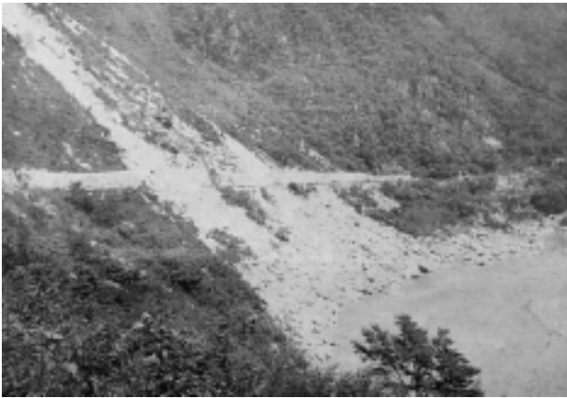
北山谷之部第七号 揖斐郡久瀬村大字東津汲大柵崩壊
