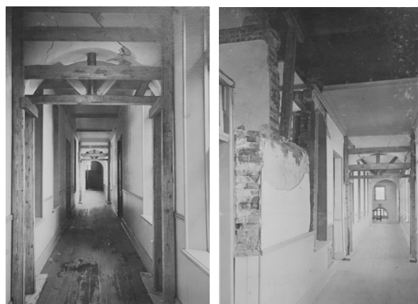
図 23 別館実験棟廊下の復旧状況 (左:一階東より写す 右:二階東より写す)
