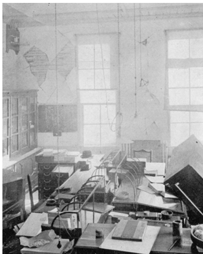
図6 本館1階会計室壁の亀裂
