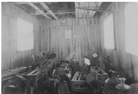
図9 蓄電池室の電池陥落
