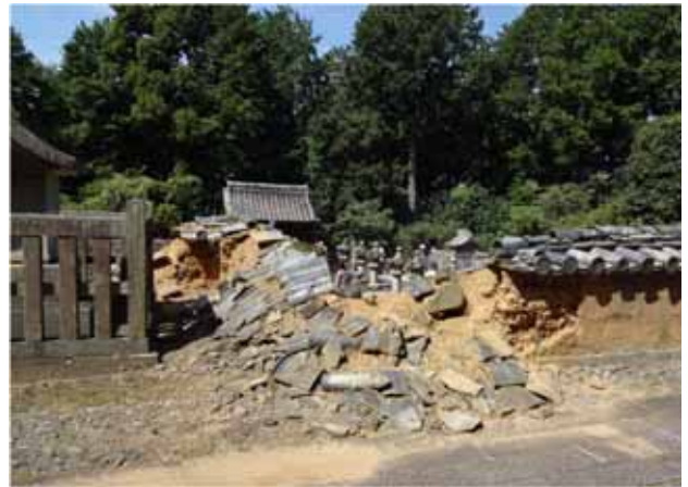
写真3. 三河地震により崩壊した塀
